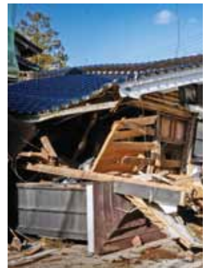
倒壊家屋 (石川県能登町)
