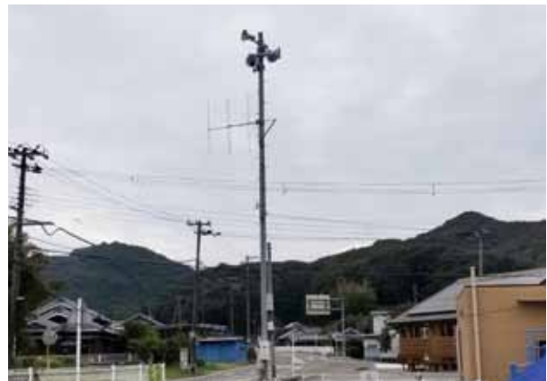
現行の防災行政無線設備
