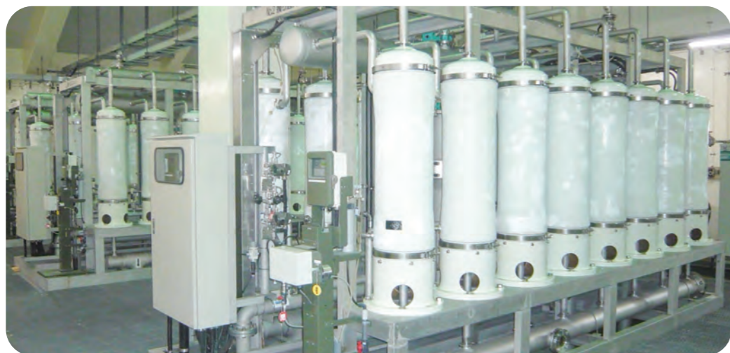
萩原浄水場 膜ろ過ユニット
